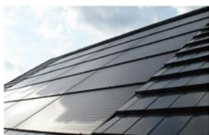
Zorgvuldig geïntegreerde zonnepanelen
